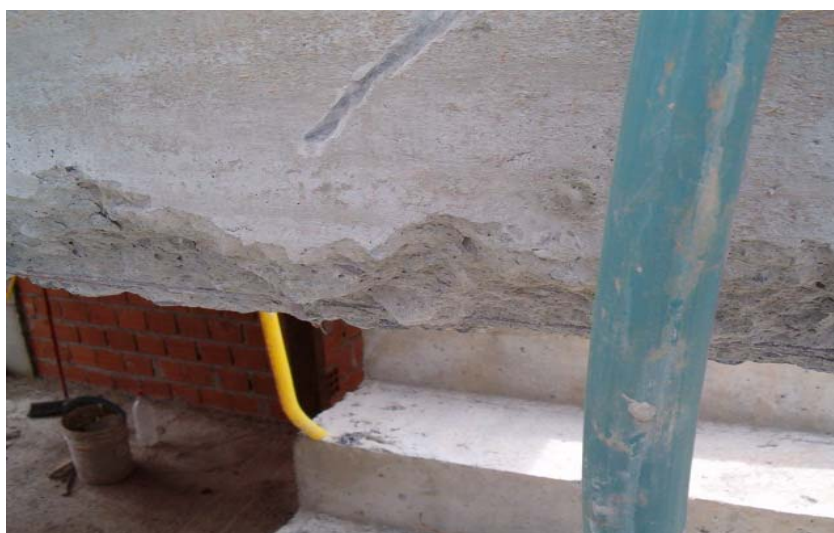
Figura 3 – Visão da patologia na aresta da viga
