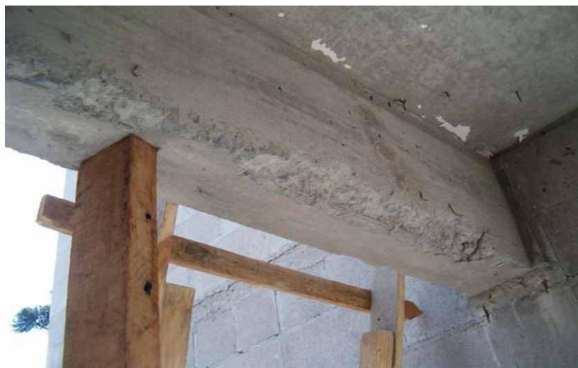
Figura 1 – Visão da patologia na aresta da viga
