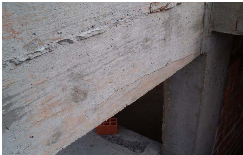
Figura 2 – Visão da patologia na aresta da viga
